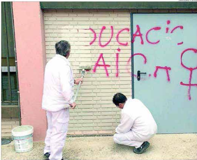
Operarios de limpieza de la universidad se encargaron de borrar ayer por la mañana las pintadas de la fachada
